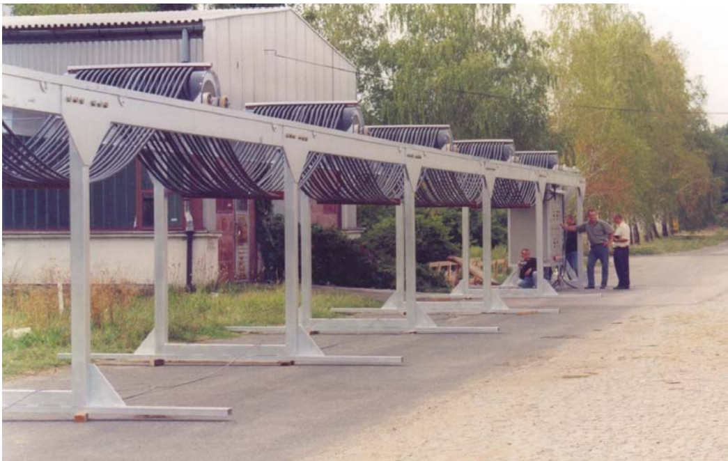
Slika 12. Razvučena kolica sa kabelima i razvodnim ormarićem po stazi
