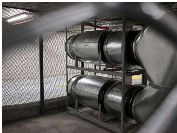
Slika 10. Sustav ventilacije i mehaničkog odimljavanja pomoću odsisnih ventilatora
