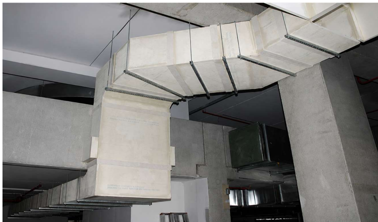
Slika 6. Sustav mehaničkog odimljavanja s kanalima za odvođenje dima
