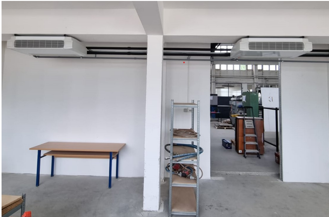
Ventilokonvektori u prostoru LTTU-a
