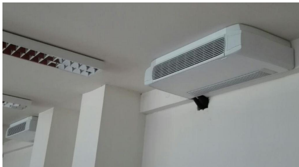
Ventilokonvektori u učionici S5
