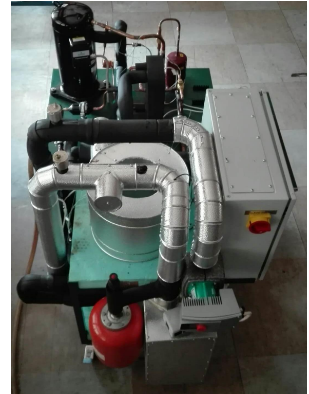
Ispitni rashladni sustav sa spiralnim kompresorom i koaksijalnim izmjenjivačima cijev-u-cijevi
