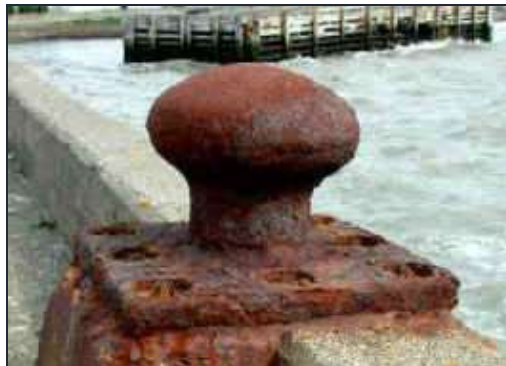
Slika 47. Primjer opće korozije [93]
