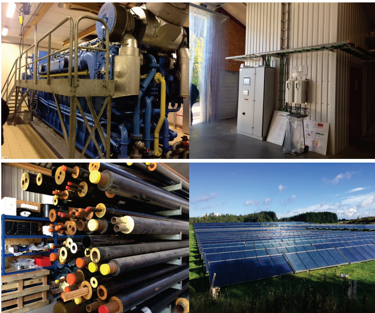
Slika 4. Plinski motor (gore lijevo), električni bojler (gore desno), distribucijske cijevi za niskotemperaturni centralizirani toplinski sustav (dolje lijevo) te solarni kolektori (dolje desno) centraliziranog toplinskog sustava u Brædstrupu
