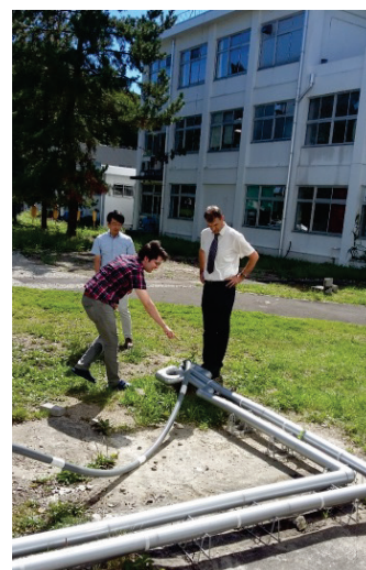
Vertikalni izmjenjivači u tlu ispitne dizalice topline
