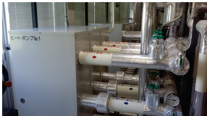
Dizalica topline voda-voda upravne zgrade JGD
