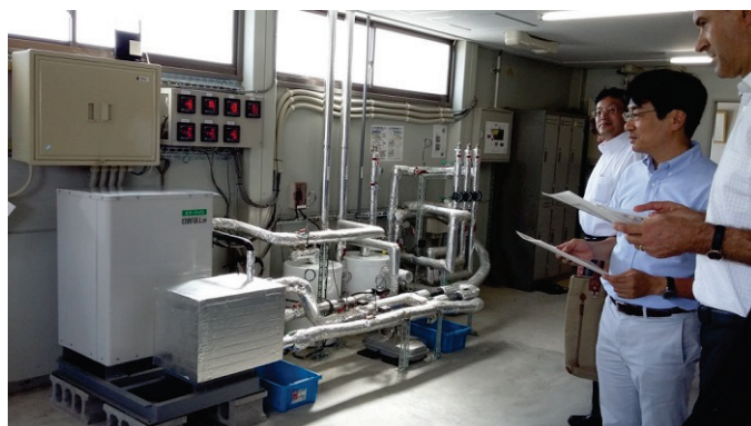
Dizalica topline voda-voda u podružnici tvrtke JGD u Akiti - Pregled rezultata mjerenja
