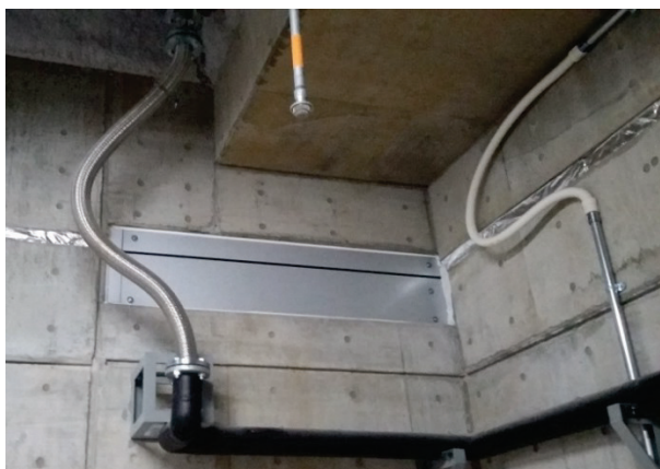
Kompenzatori potresa na zgradi Gradske vijećnice, dilatacije na cjevovodima
