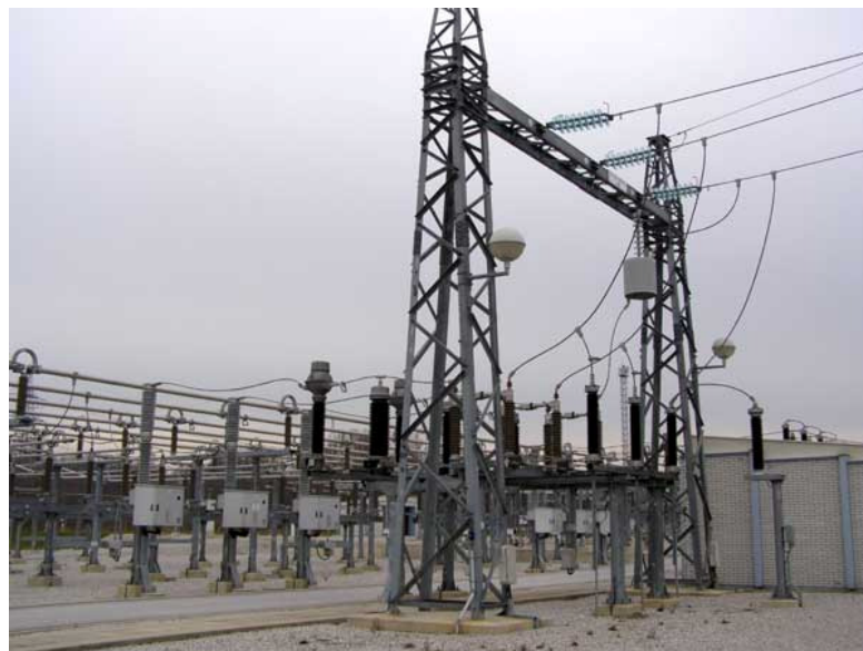
Slika 2 - 1: Mjerni transformatori ugrađeni na TS 400/220/110 kV Žerjavinec
