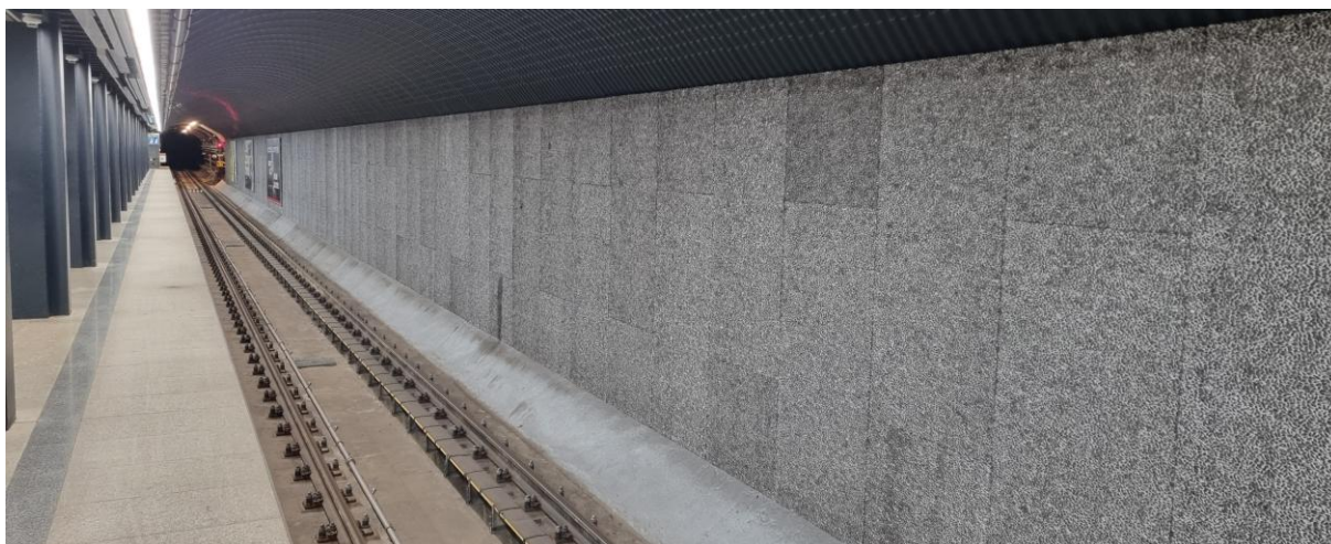
Slika 2.14 Zidni paneli za prigušenje buke na stanici podzemne željeznice u Budimpešti
