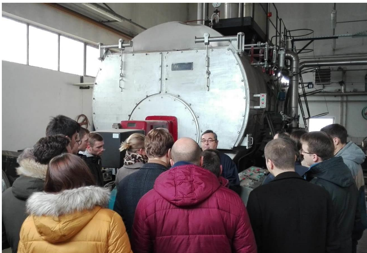
Parni kotao učinka 5 MW
