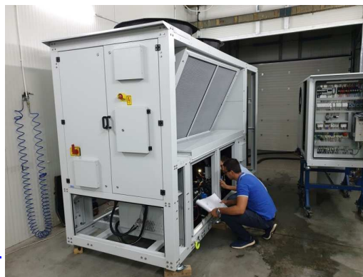
Rashladnik vode „Chiller“
